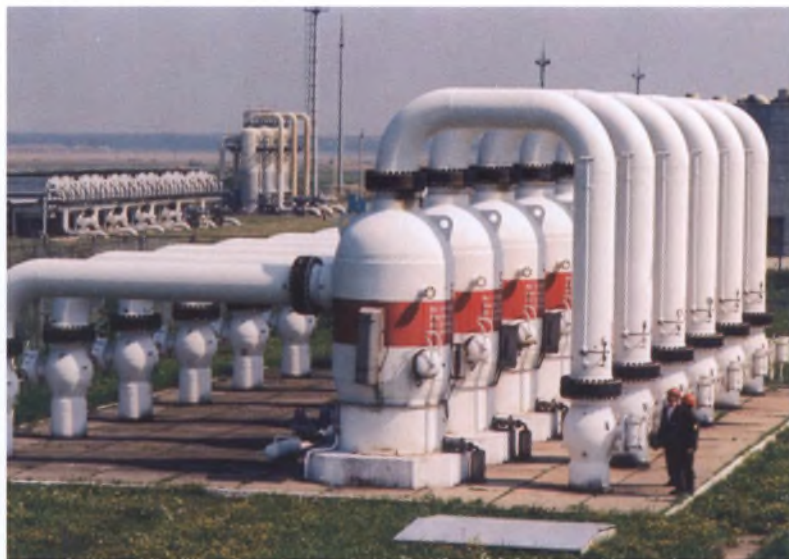
Компрессорная станция газопровода «Дружба».
