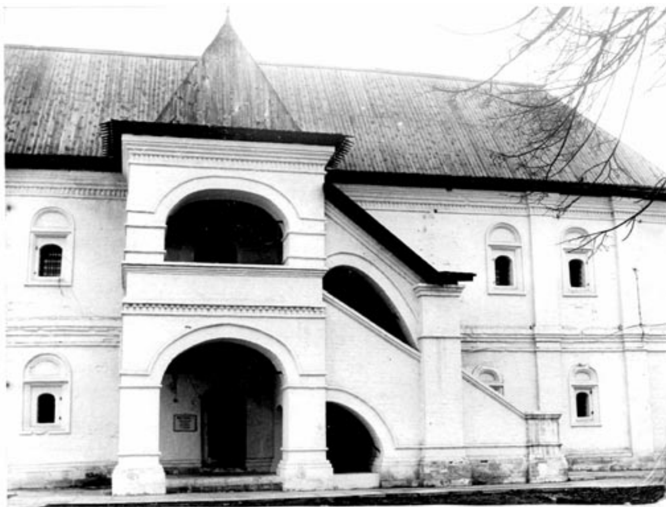
Вид западного фасада Певческого корпуса после воссоздания высокой тесовой кровли в 1979-80 г.г. Не восстановлены дымоходы и нет пик на полнице. У крыльца без согласования с арх. И.В.Ильенко пристроено нижнее ограждение лестницы с тумбой.
