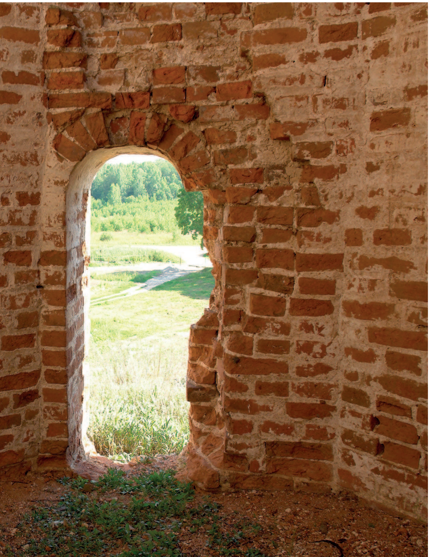
Помещение в звоннице без колоколов Алексевской церкви; в правом верхнем углу немного заметно растущее утолщение кладки – это не видимый снаружи секрет многих шатровых колоколен, контрфорс наоборот.
