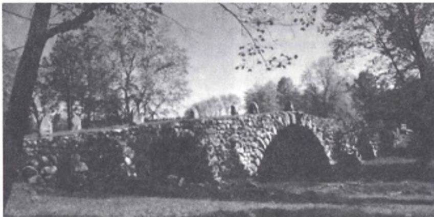
Валунный мост в усадьбе Василёво. 1780-е гг. Фото А. Кравченко 1990-х гг.
