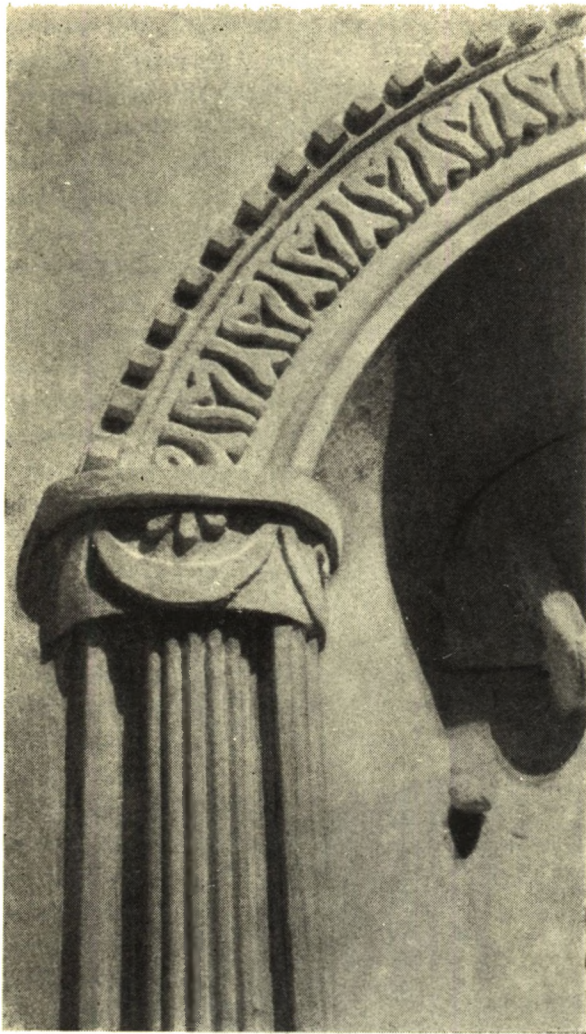
Рис. 33. Троицкий собор в Пскове. Часть оконного наличника
